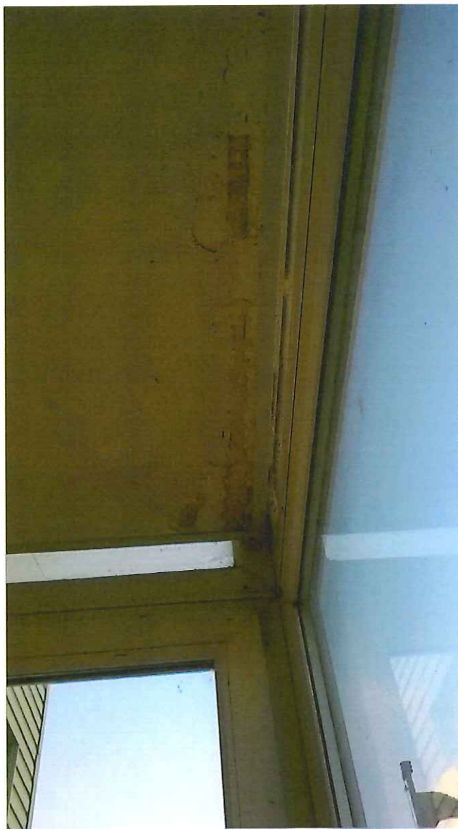
10 pav. Drēgmēs pažeista laiptu aikštelē
