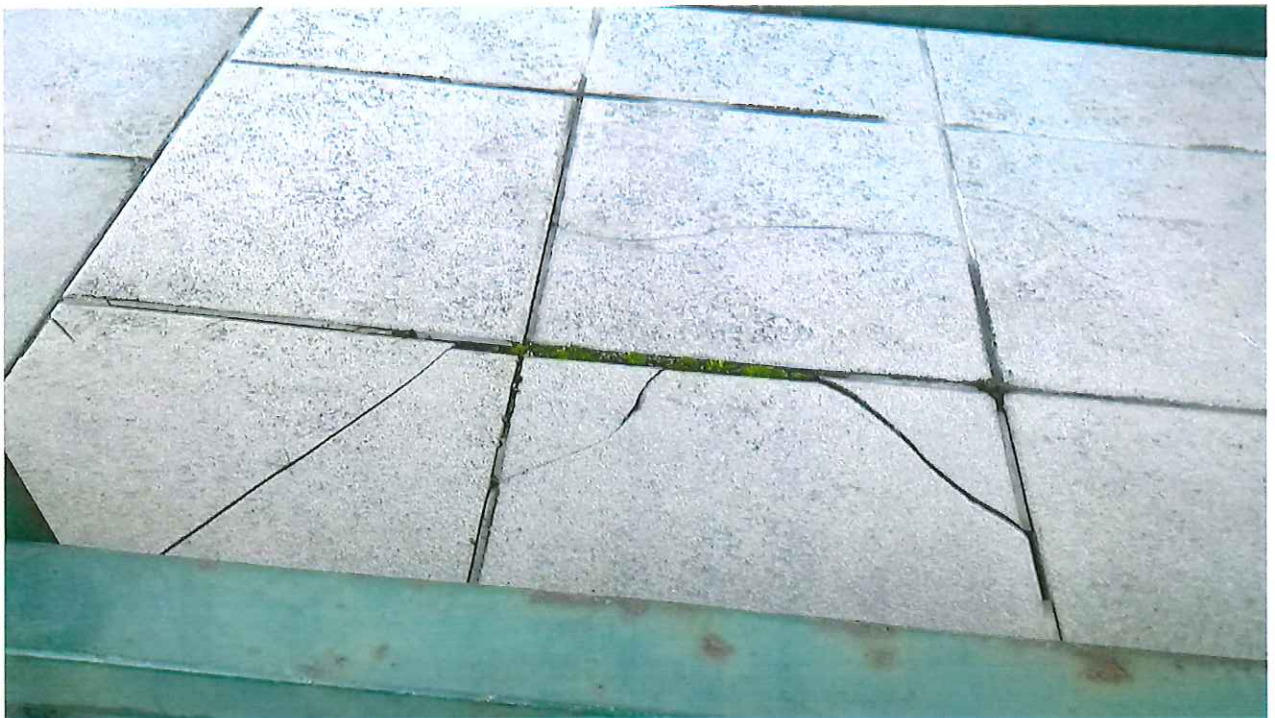
7 pav. Suskilinėję laiptų aikštelės apdailinės plytelės
